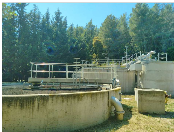
La station d'épuration à Orgon
